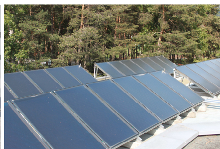
Panneaux solaires thermiques (ECS)
